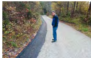
Beim touristischen Schlossweg wurde eine Asphaltmulde errichtet, da es in diesem Bereich immer massive Ausschwemmungen gab.
